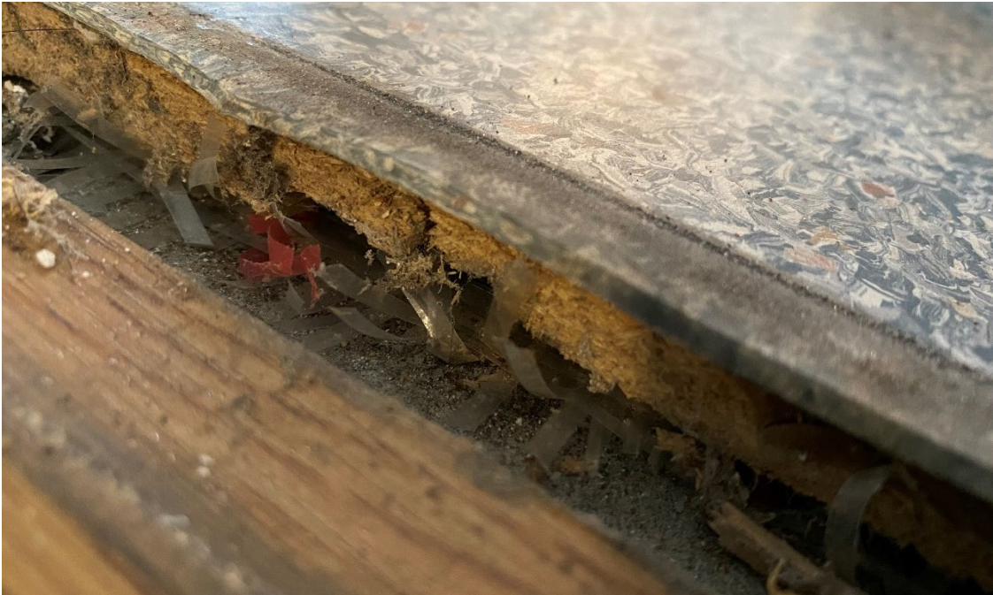
Foto 11. Närbild på renoveringsgolv i personalrum med uppfuktad träfiberskiva i tröskelområdet utan ångspärr.
