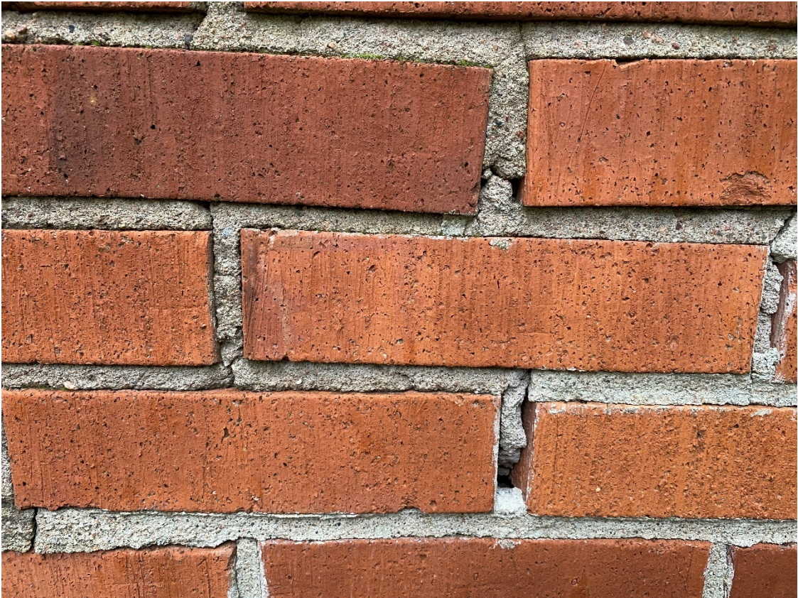
Foto 25. Närbild på bristande fogar med tydliga otätheter och risk för fuktskador i ytterväggar.
