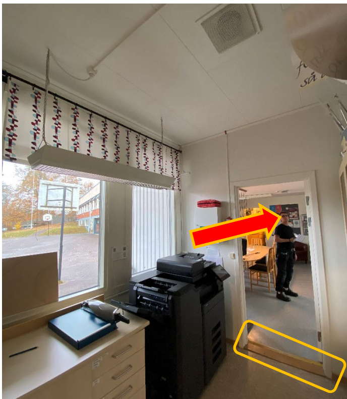
Foto 10. Passage mellan printer- och personalrum samt undersökt tröskelområde. Risk för försämrad inommiljö i personalrum med emissions och partikelalstrande printer/kopiator i närliggande utrymme utan frånluftsventilation, endast tilluft.
