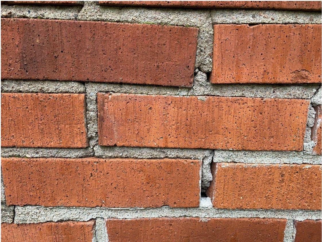
Foto 25. Närbild på bristande fogar med tydliga otätheter och risk för fuktskador i ytterväggar.
