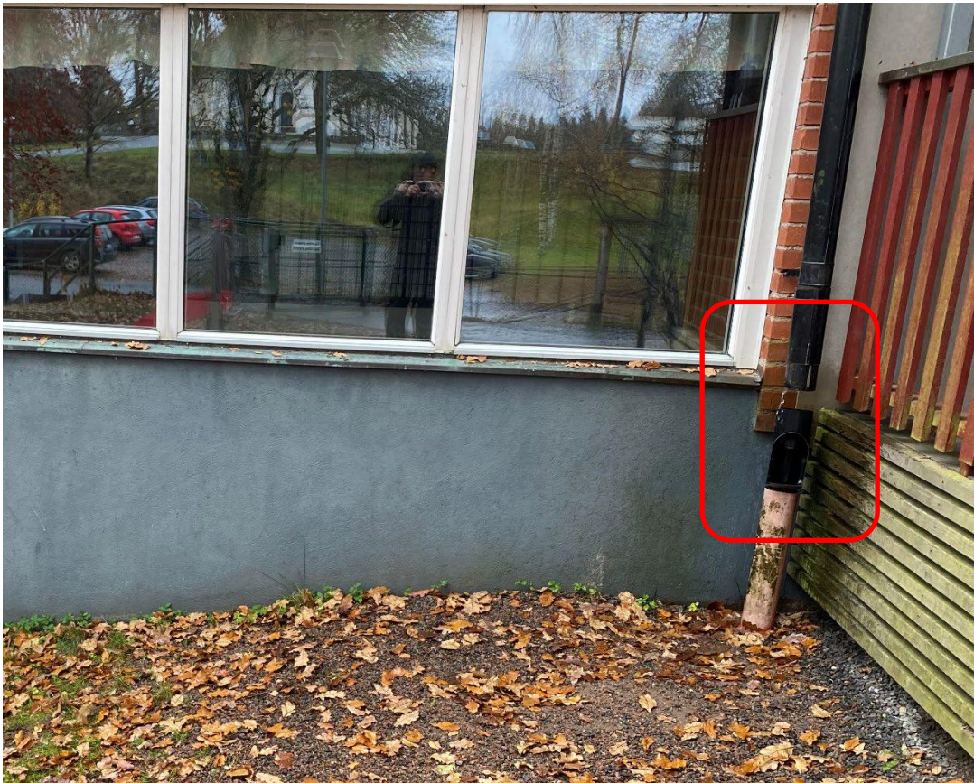
Foto 23. Ytterligare exempel på lokal uppfuktning av fasad och markyta, här vid avsaknad av stuprörsanslutning till lövsil. Läget är vid fuktskadat område i trapphuset.
