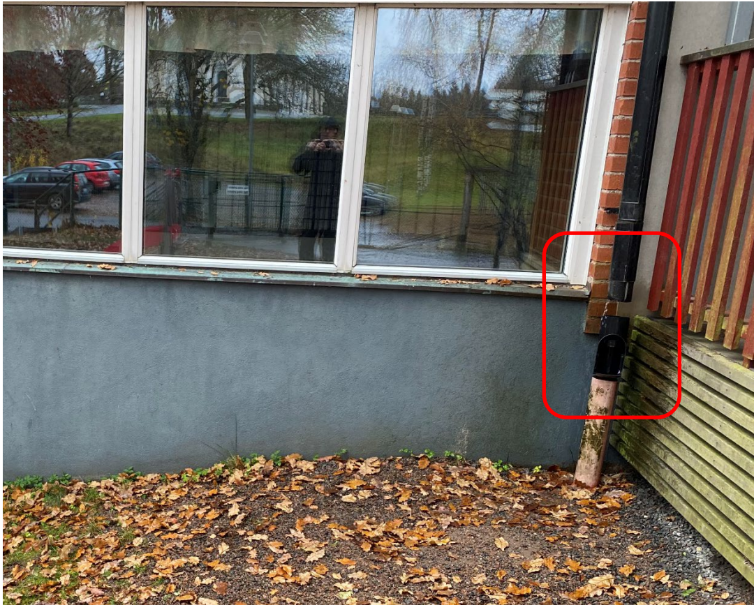
Foto 23. Ytterligare exempel på lokal uppfuktning av fasad och markyta, här vid avsaknad av stuprörsanslutning till lövsil. Läget är vid fuktskadat område i trapphuset.
