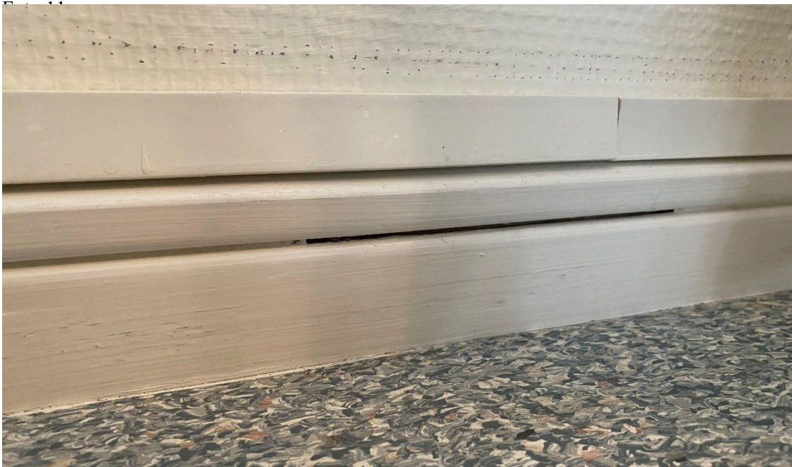
Foto 13. Ventilationsspalter för uppreglat golv men inget tecken på mekaniskt ventilerat.
