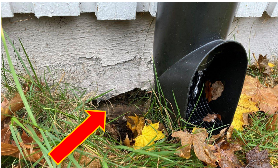
Foto 16. Ytterligare exempel på avsaknad av puts och här vid lövutkast och tydliga tecken på uppfuktning av sockel. Detta läge är alldeles utanför M2, rum B121 med förhöjd fuktnivå i plattan.
