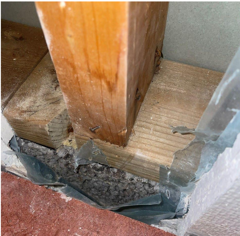
Foto 4. Frilagd yttervägg i bibliotek (M1) med synlig impregnerad syll, mineralullsremsa under syll, rinnmärken och rostig spik i stående regel, lättklinkerbetongsten, pappbeklädd vindskiva(gips) samt PE-folieanslutning oklart monterad, möjligen under platta?
