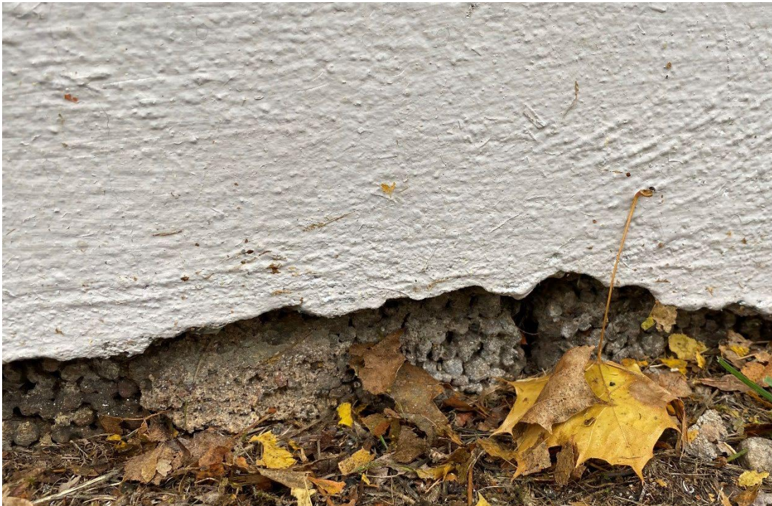
Foto 15. Avsaknad av puts på lättklinkerbetongsten vid mark.
