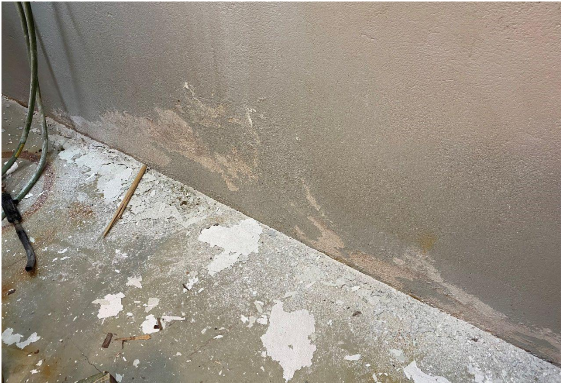
Foto 21. Tecken på tillskjutande fukt i metallslöjden vid motfylld yttervägg.
