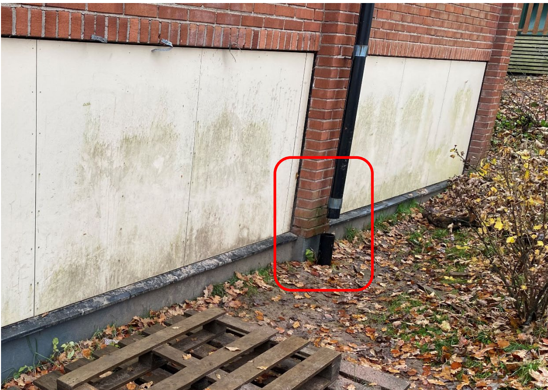
Foto 22. Avsaknad av lövsil och lokal uppfuktning av fasad och markyta vid takavvattning observerads på några platser.
