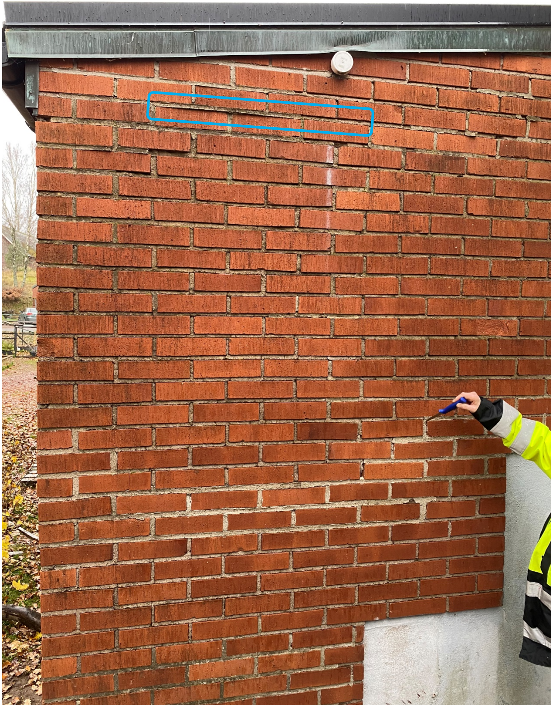
Foto 24. Tecken på otätheter i fogar på hus A. Blå markering visar sannolikt tecken på korroderad armering i fog.
