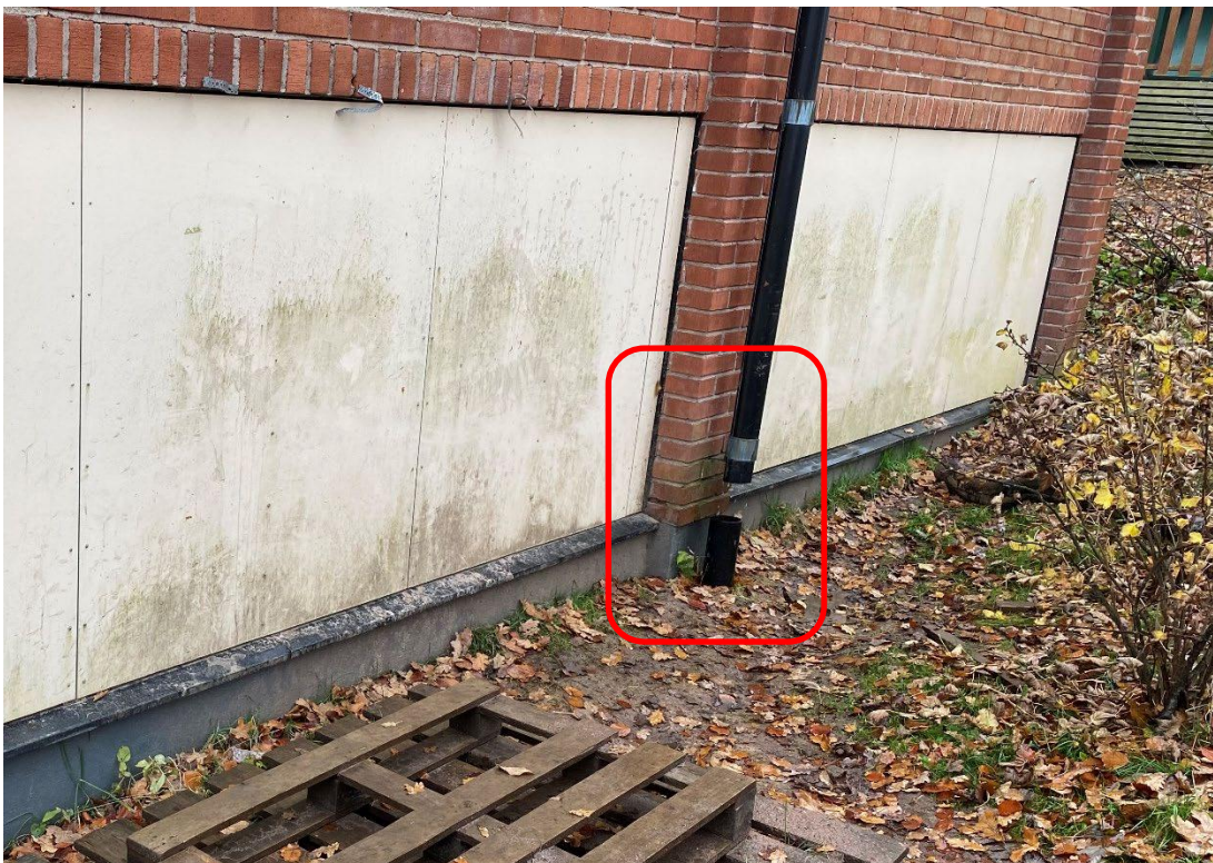
Foto 22. Avsaknad av lövsil och lokal uppfuktning av fasad och markyta vid takavvattning observerads på några platser.
