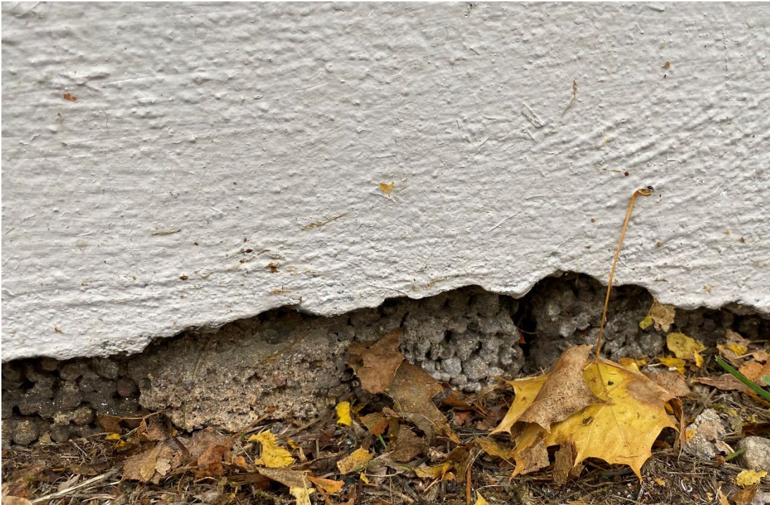
Foto 15. Avsaknad av puts på lättklinkerbetongsten vid mark.
