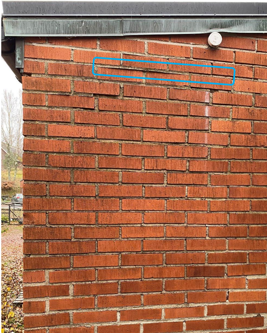
Foto 24. Tecken på otätheter i fogar på hus A. Blå markering visar sannolikt tecken på korroderad armering i fog.
