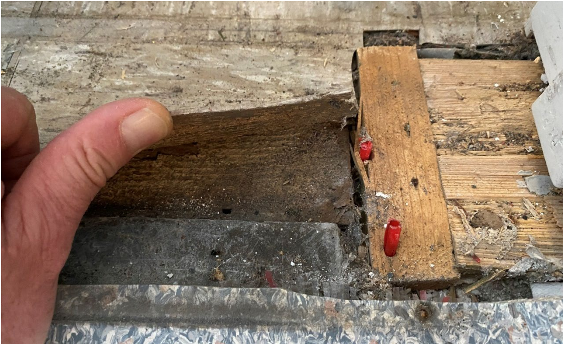
Foto 12. Närbild på intilliggande äldre plastgolv i printerrum och syl, för tidigare demonterad dörrkarm, med förhöjd fuktnivå och tydligt avvikande mikrobiell lukt i konstruktionen.
