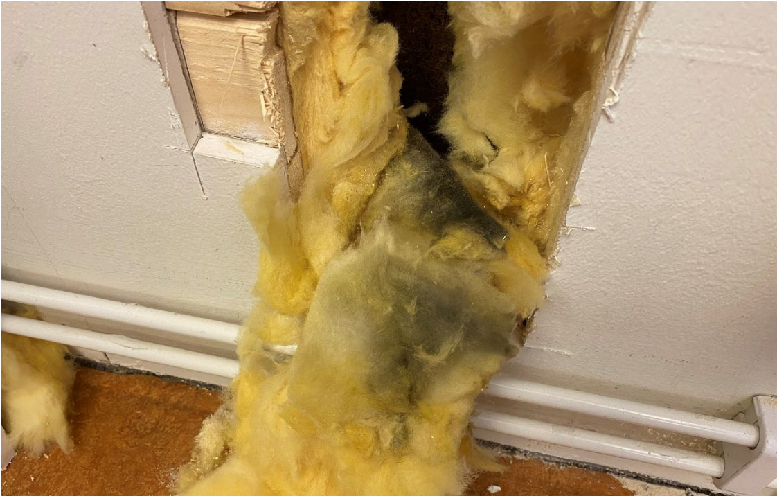
Foto 7. Frilagd yttervägg (M7) med tydliga tecken på infiltrationsnedsmutsning av isolering.
