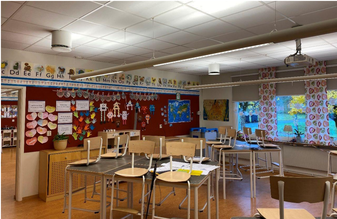
Foto 5. Bakre delen av sal B125 med två synliga tilluftsdon och frånluftsdon vid vägg/takvinkel.
