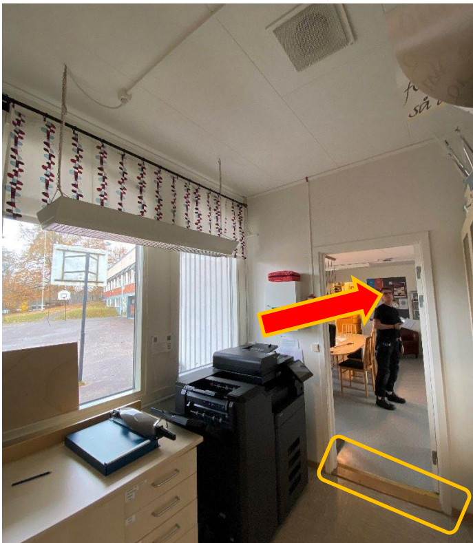
Foto 10. Passage mellan printer- och personalrum samt undersökt tröskelområde. Risk för försämrad innemiljö i personalrum med emissions och partikelalstrande printer/kopiator i närliggande utrymme utan frånluftsventilation, endast tilluft.
