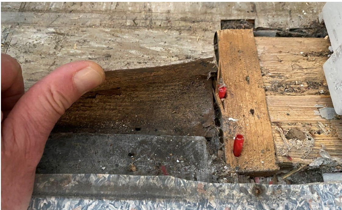
Foto 12. Närbild på intilliggande äldre plastgolv i printerrum och syl, för tidigare demonterad dörrkarm, med förhöjd fuktnivå och tydligt avvikande mikrobiell lukt i konstruktionen.
