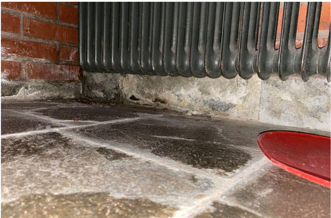
Foto 20. Tydliga tecken på tillskjutande fukt i trapphus vid motfylld yttervägg.
