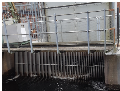
Gallret vid intaget till kraftstationen
