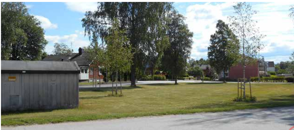
Foto över befintlig parkmark i planområdets östra hörn. Grönytan säkerställs som park och skötas av Gislaveds kommun. Till vänster i bild syns transformatorstation inom föreslaget E-område.
